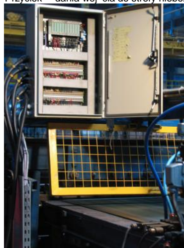
Rys. 10 Szafka stacji ET 200S slave
