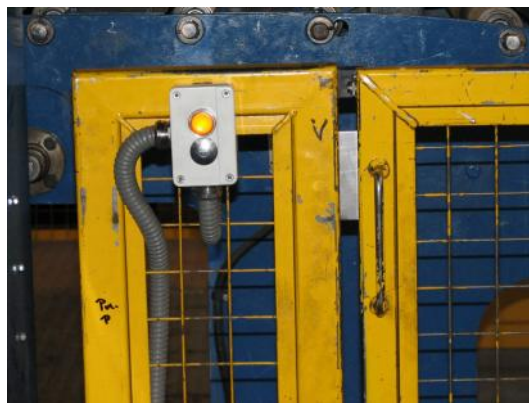
Rys. 8 Przycisk dający wejście do strefy niebezpiecznej
