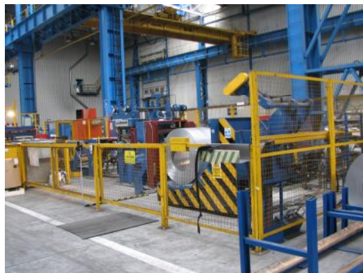
Rys. 2 Ogródzenie ochronne wokół maszyny
