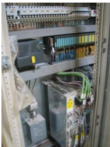
Rys. 3 Szafa sterująca z SIMATIC F
