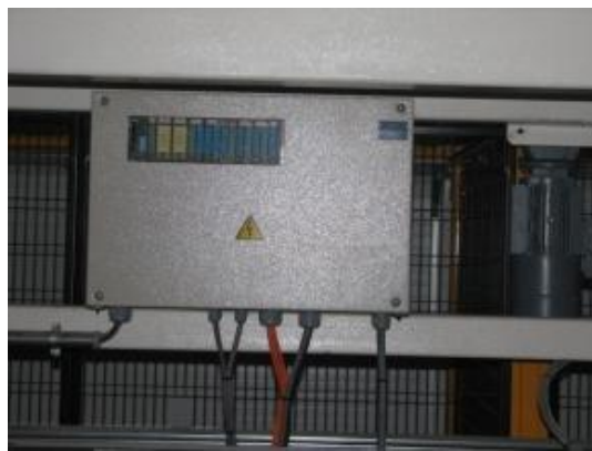
Rys. 6 Wyspa ET200S w szafce
