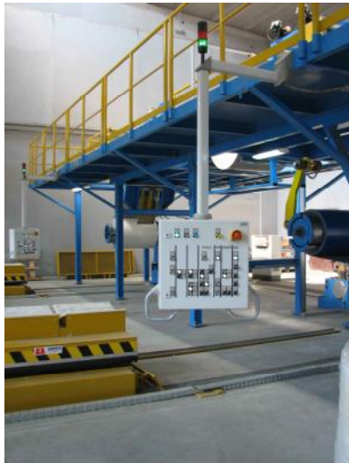
Rys. 12 Panele sterowania lokalnego (z AW)
