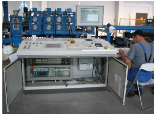
Rys. 13 Pulpit sterowania lokalnego (z AW) z panelem TP 270 i stacją wizualizacji SIMATIC Box PC
