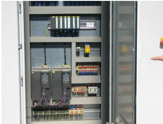
Rys. 6 Stacja ET200M steruj ca nalewakami
