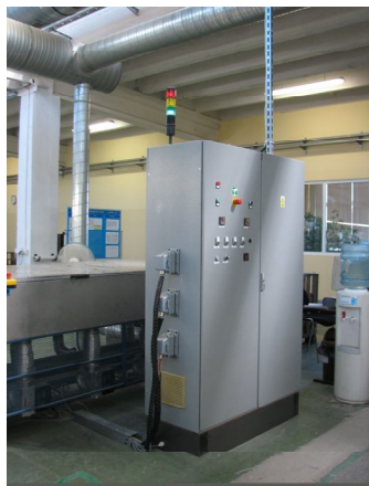
Zdj. 1 Szafa sterownicza linii produkcyjnej
